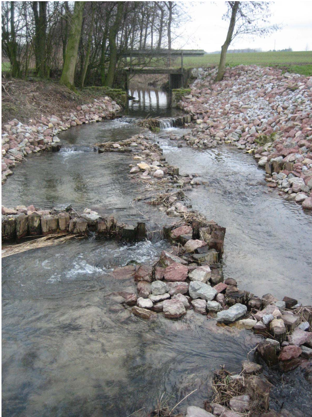
Abb. 68: Beispiel für eine Kolkterrasse, hier an einem kleinen Gewässer mit entsprechend kleinen Niedrigwasseröffnungen in den einzelnen Kolk-schwellen; um auch hier Hochwassereinflüsse zu mindern, wurde rechts das Hochwassergerinne angelegt (im bisherigen Verlauf der Steinfurter Aa), links der Aufstiegsbereich mit den definierten Öffnungen in den Kolk-schwellen. Durch Öffnungsbreite und Zahl der Kolke lässt sich die Durchgängigkeit exakt austarieren
