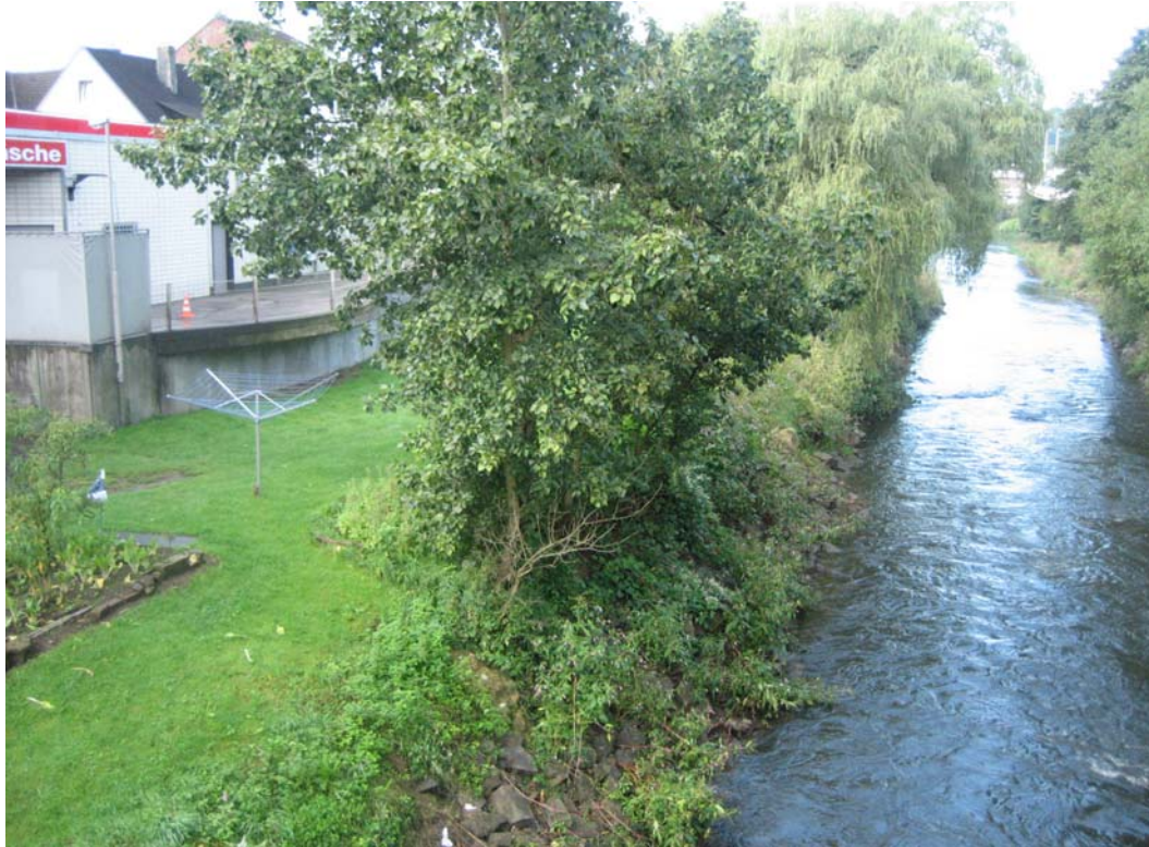
Abb. 74: Siegkanalisierung in Siegen; das Ufer ist mit Wasserbaupflaster vermauert, selbst die Restaue zwischen Pflasterung und der links im Hintergrund erkennbaren Hochwasserschutzmauer wird nicht dem Gewässer überlassen, sondern als Gemüsebeet und zum Wäschetrocknen genutzt
