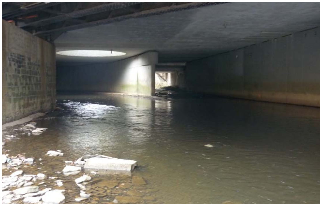
Abb. 44: Verrohrter Zusammenfluss zweier Vorranggewässer, hier von Sieg und Heller; die runde Lichtöffnung kann nicht verhindern, dass eine ökologische Situation wie unter einer Hochstraße geschaffen wurde.
