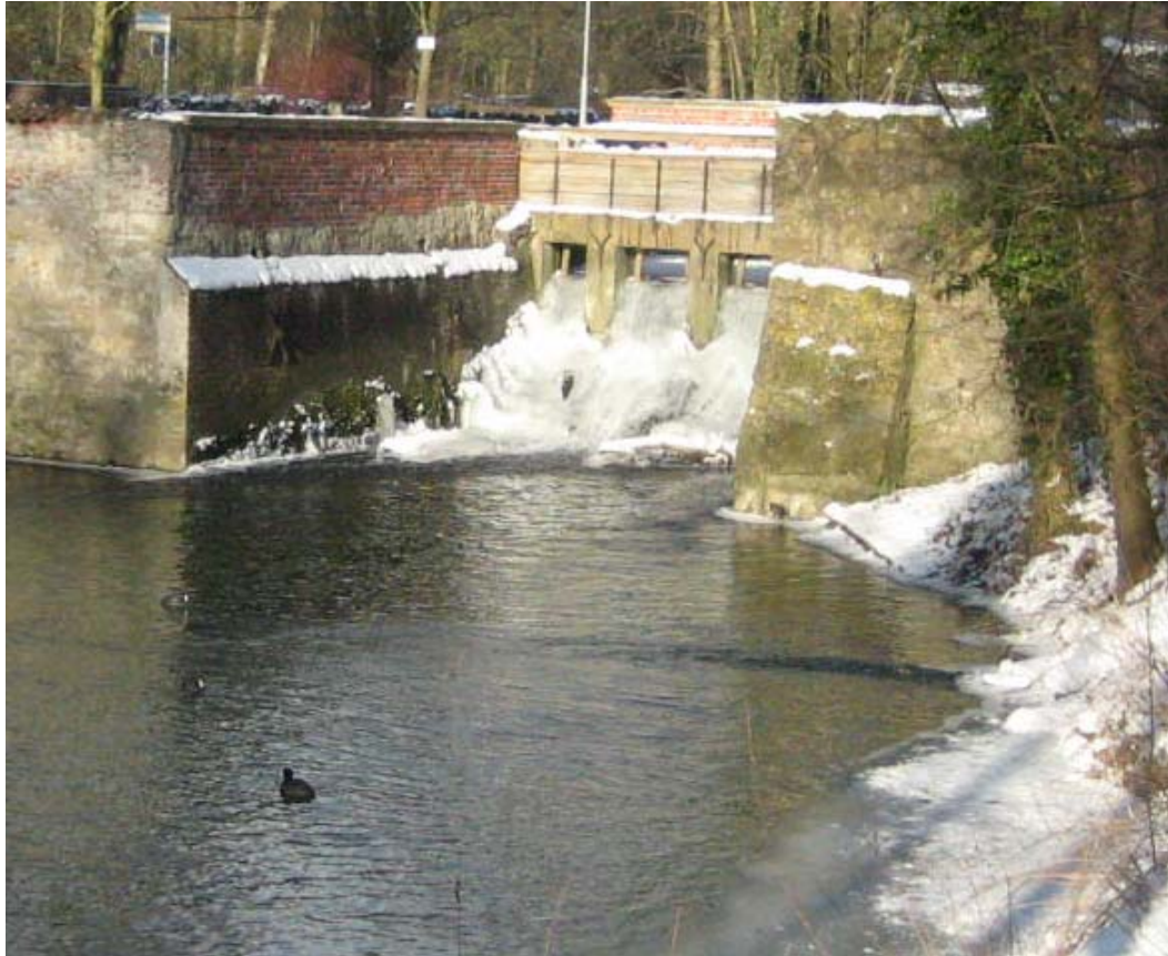
Abb. 69: Einleitung aus einem Rohr DN 150 im Umfang von etwa 12 bis 15 l/s; gut erkennbar an der dunklen Wasseroberfläche, wie weit die Strömung direkt in den Kolk reicht, um dann ins Unterwasser abzudrehen, wo sie immer noch identifiziert werden kann
